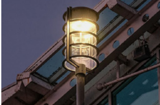
Abb. 147: Straßenbeleuchtung Firma Hess, Typ „Village“, DB 703.
