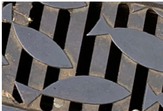
Abb. 178: Entwässerungsablauf aus Gusseisen (Motiv Stör).
